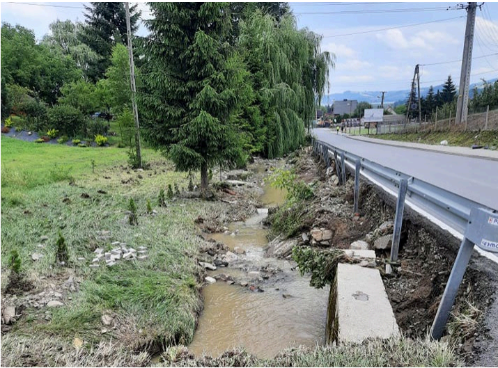
Rysunek 18. Uszkodzenia w infrastrukturze drogowo-mostowej spowodowane intensywnymi opadami atmosferycznymi w 2021 roku
